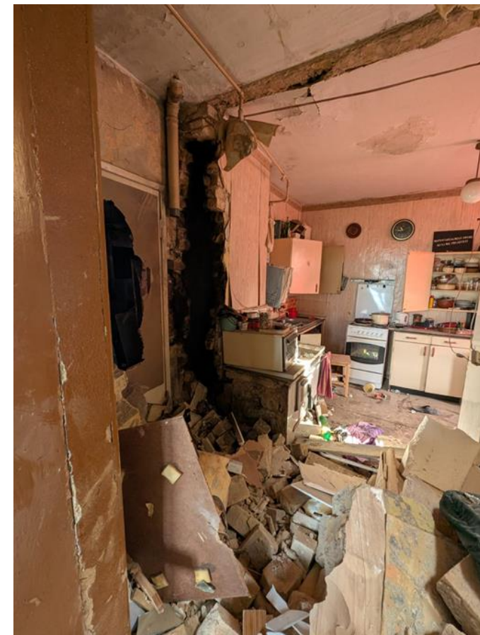
Wybuch w budynku mieszkalnym - 5 listopada 2025 r.
