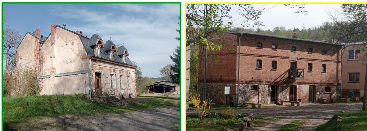
Rycina 11. Przykłady przestrzeni wymagających poprawy stanu technicznego na obszarze rewitalizacji
