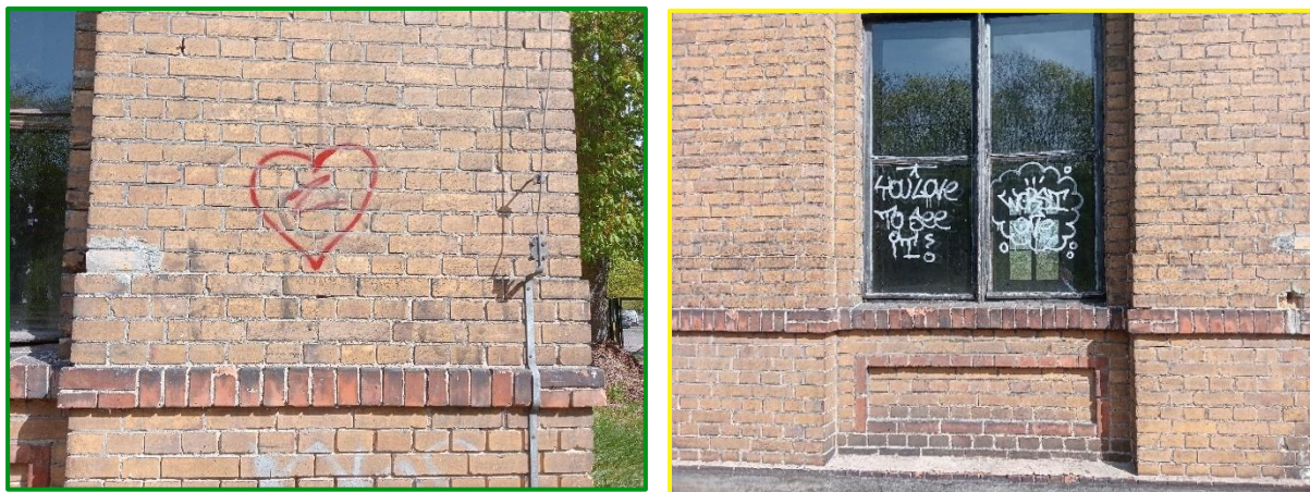
Rycina 8. Przykłady aktów wandalizmu na obszarze rewitalizacji: graffiti na budynkach
